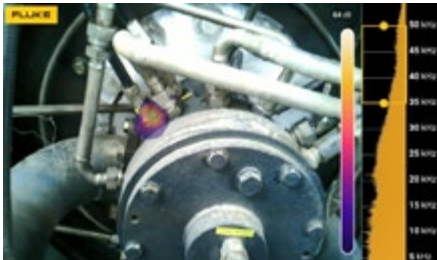
某大型气体生产企业，氮气生产线气泄漏
