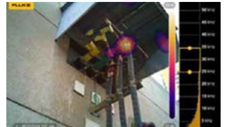
穿墙套管接头放电
