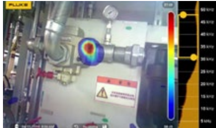
某制造企业配气室气体泄漏
